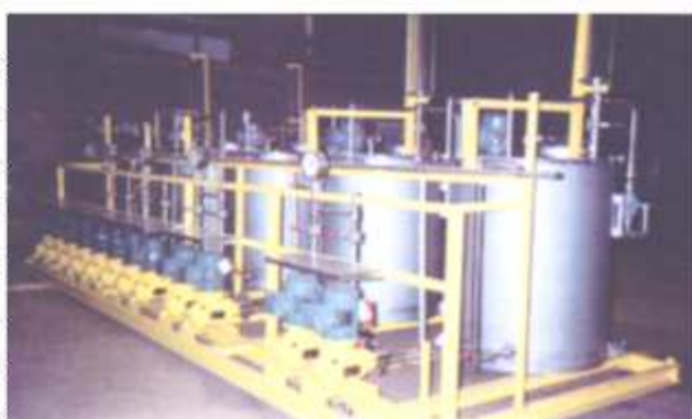
Cuves inox avec pompes doseuses
